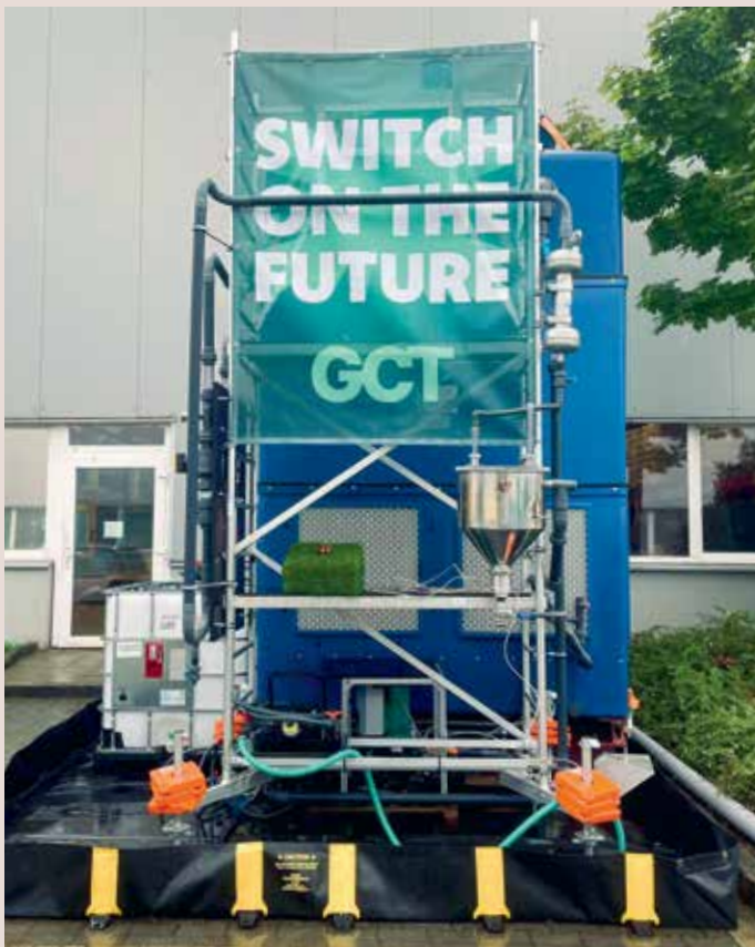
Die DAC-Demo-Anlage in Essen besitzt eine Jahreskapazität von 100 Tonnen Kohlendioxid.
